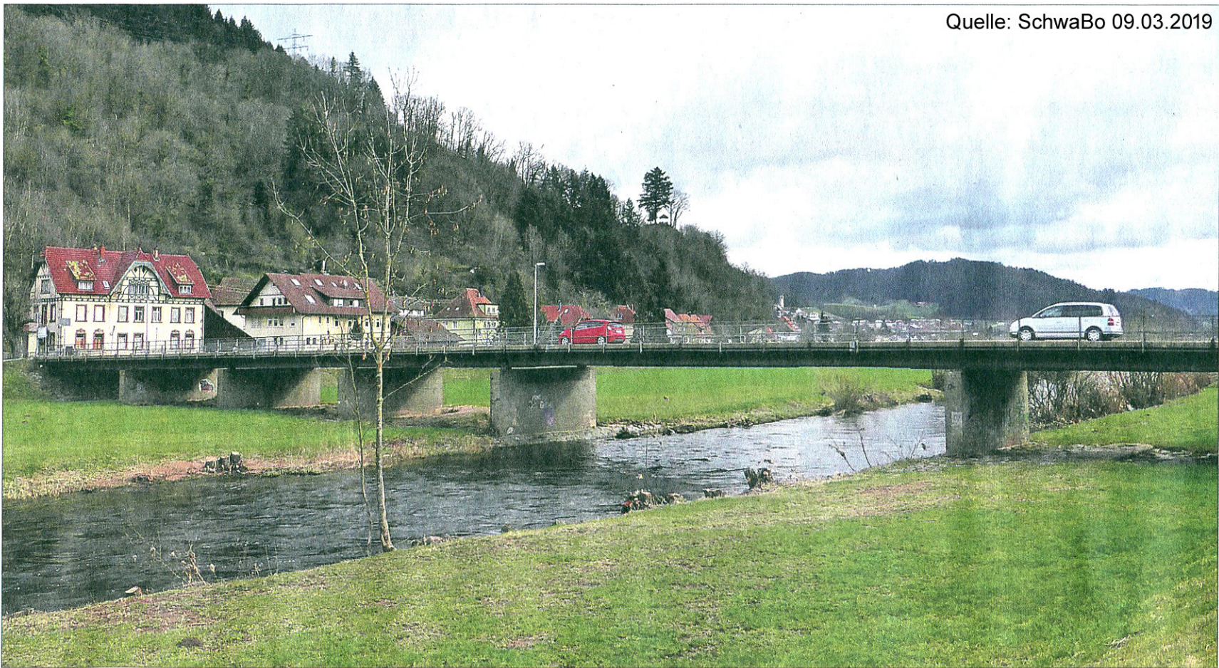
Die Kinzigbrücke in der Haslacher Schleifmatt – die sogenannte Arche-Brücke ist marode. Für den Schwerlastverkehr wird sie ab Montag, 11. März, gesperrt. Fahrzeuge mit mehr als 7,5 Tonnen zulässigem Gesamtgewicht müssen dann durch Schnellingen nach Fischerbach fahren. Fotos: Kleinberger
